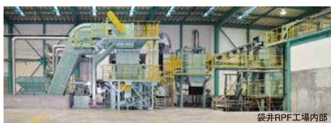
袋井RPF工場内部
