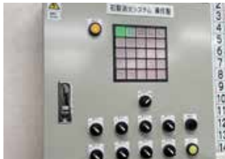
3.報知「積層信号機付電子音報知機」 警報音を鳴らし火災箇所を確認、散 水設備を起動します。
