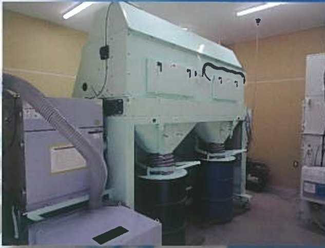
大川工場に設置された密閉式蛍光灯破砕処理機
