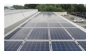
都田発電所北側
